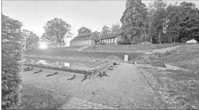
Foto: Helmut Will Das Freibad Altenstein wird saniert. Die Arbeiten haben begonnen. Hier geht die Sonne gerade unter und alle hoffen darauf, dass sie nach der Bauzeit wieder für die Badbesucher scheint. Foto: Helmut Will
